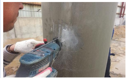
센서 설치 준비
